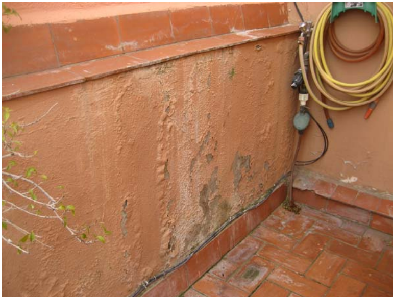
Foto 5.- Estado deficiente revoco murete-pared medianera.
