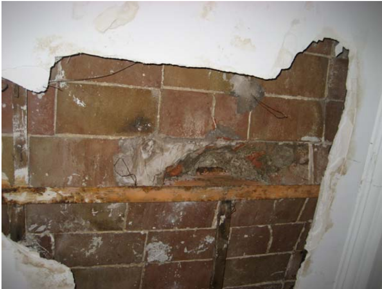
Foto 1.- Detalle abertura, manchas humedad y oxidación.
