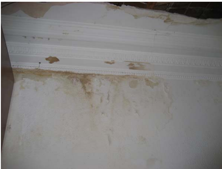
Foto 2.- Afectación en pared medianera.
